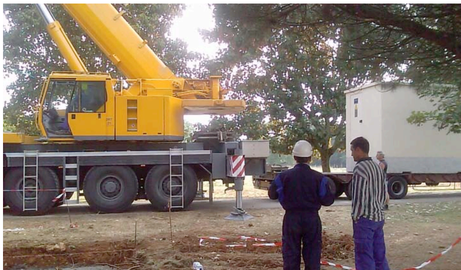
Livraison d'un poste / Crédit photo Sergies
